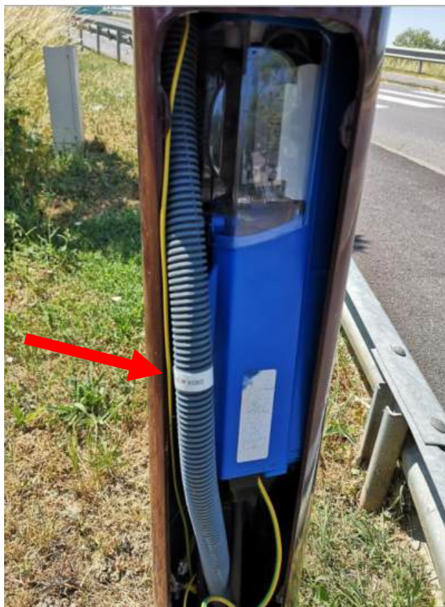
Etiquetage d'un câble
