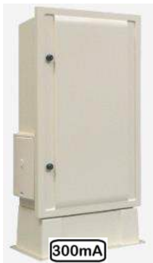
Armoire de commande EP
